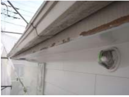
【破風板塗膜劣化部 剥離】
