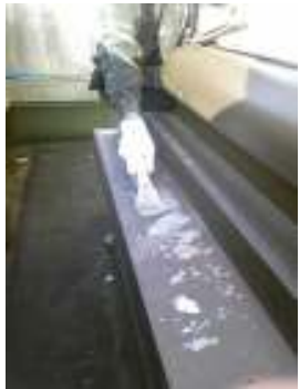
脆弱塗膜剥離
