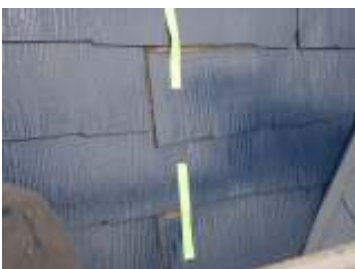
【スレートのズレ確認】
